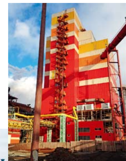
Установка вдувания пылеугольного топлива на ОАО «НТМК», г. Нижний Тагил
